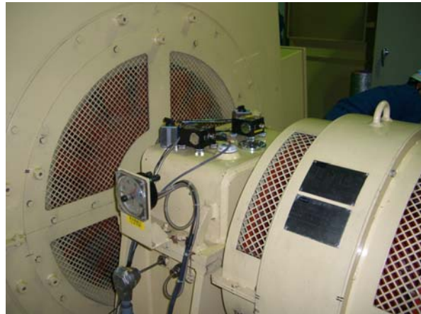
発電機軸受(振動、回転数を計測)
